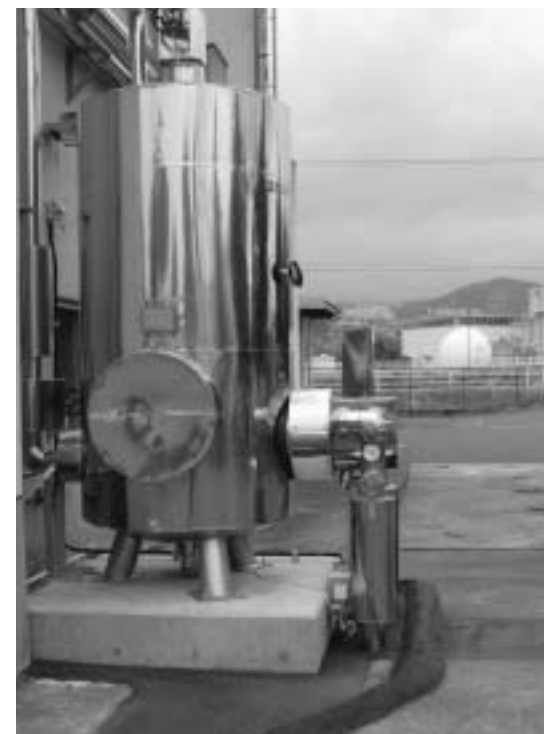
シリウス(右奥)から供給される温水を貯湯する、ストレージタンク
