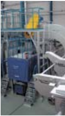
移送コンベアと分別機
