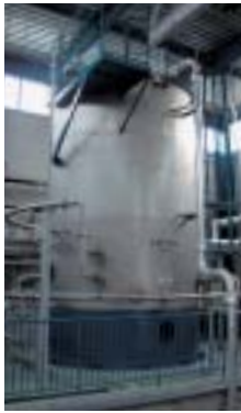
スラリータンク
