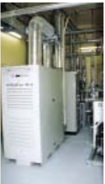
マイクロガスタービン発電機
