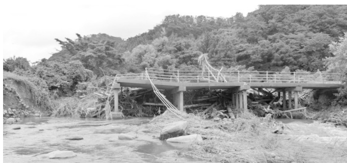
架け替えとなる被災した市道三住線の大岩橋
