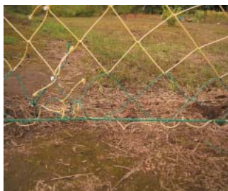
出入口のネット下端と地面の間にできた隙間
