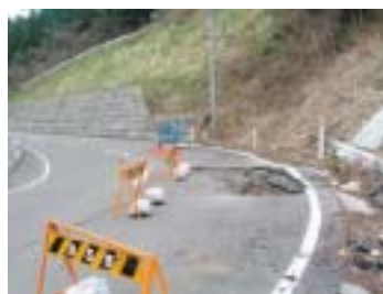
隆起した道路
