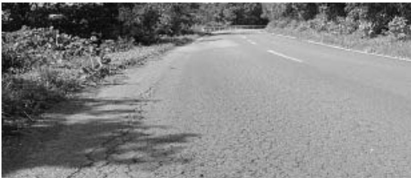
凍上災によってひび割れた路面
