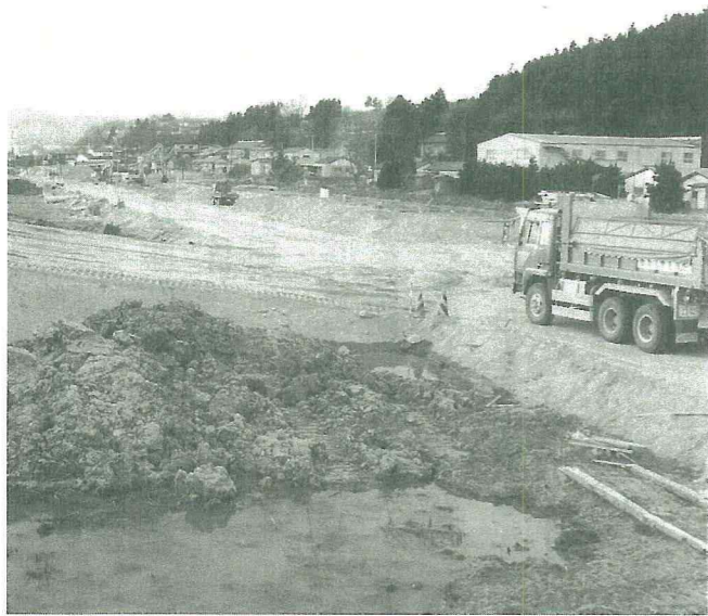
▲新幹線駅前の新しい顔づくりを目指して造成が進む鷹巣土地区画整理地域
