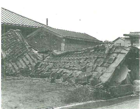
▲昭和53年 宮城県沖地震で大きな被害
