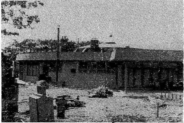
白石南保育園完成 総坪数 600.340㎡ 工費 1,500万円 円筒式鉄筋コンクリート平屋建の近代的な建物です。 内訳事務室1 保育室6 機械室1 小使室1 給食室1 律動室1
