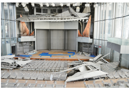
天井がステージや客席に落下したコンサートホール
