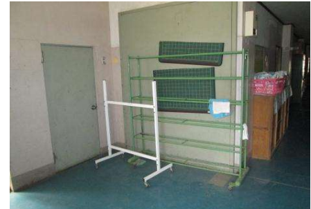
写真1：障害物が置かれている防火戸
