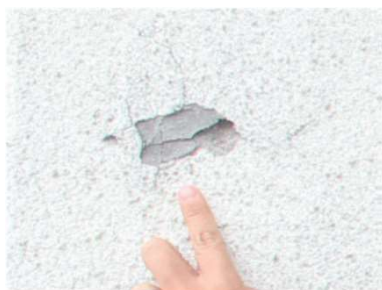
写真1：内壁の浮き，剥落
