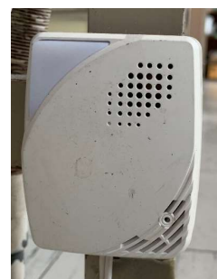
写真1：ガス漏れ警報器
