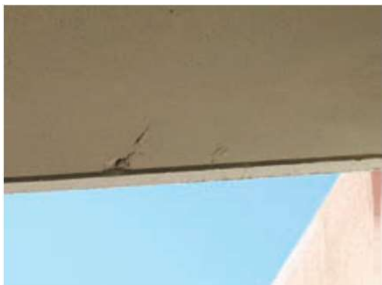
写真1：階段裏のひび割れ
