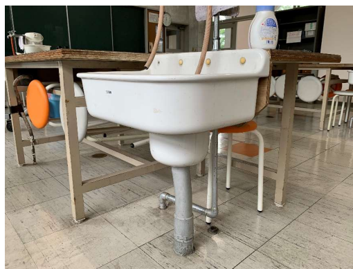
写真1：洗面台の漏水
