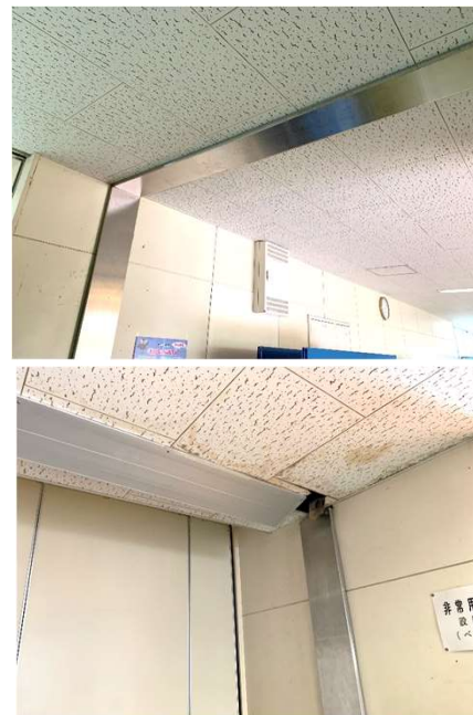
写真1：変形した エキスパンション・ジョイントカバー
