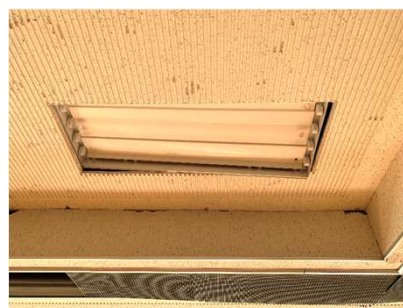
写真2：地震で落下しそうな照明
