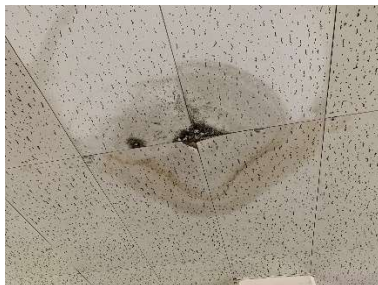
写真2：天井材の染み、破損
