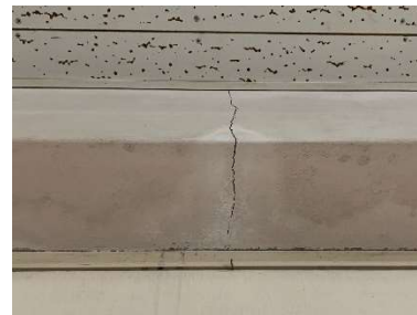
写真3：梁のひび割れ
