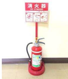
写真3：消火器の設置場所
