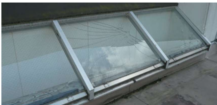
写真1：窓ガラスのひび割れ
