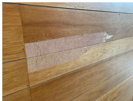
写真1：床のささくれ
