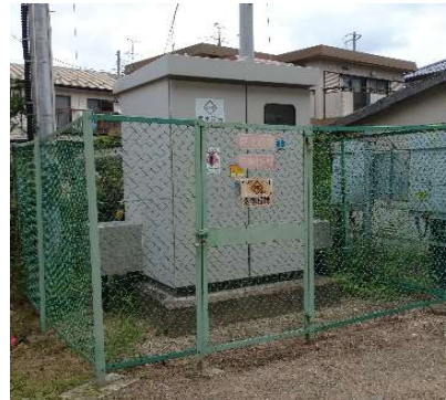
写真1：キュービクル
