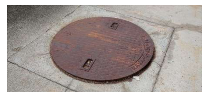
写真2：段差が見られるマンホール
