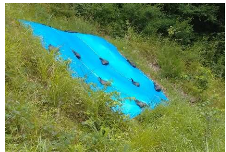
写真2：崩壊部分を覆ったブルーシート
