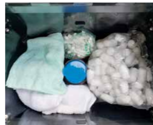
▲保温したメーターボックス
