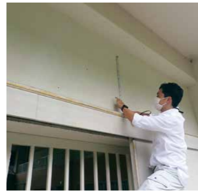
▲小原中学校外壁のクラックの延長・幅の計測
