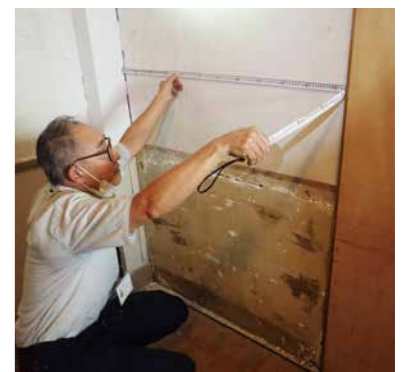
▲深谷小学校体育館内壁の損傷範囲の計測
