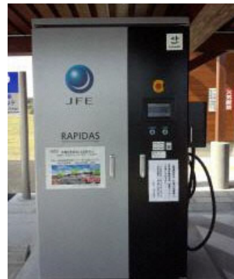
EV 充電設備
