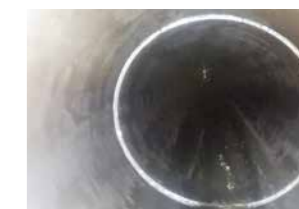
▲清掃後の正常な下水道管
