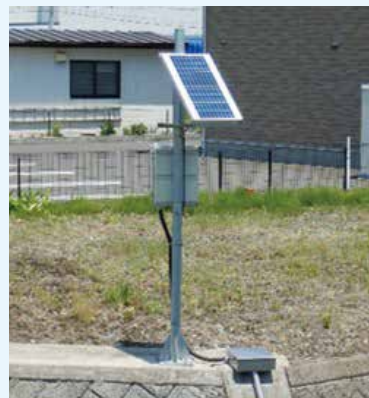
▲危機管理型水位計 設置例 (大太郎川 深谷妙見橋)
