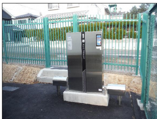
城南加圧ポンプ外観
