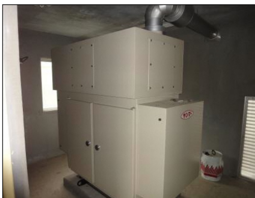
自家発電設備
