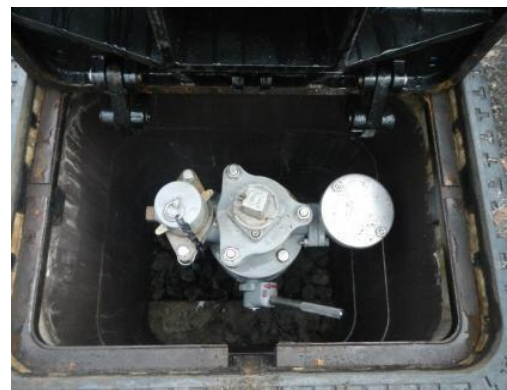
緊急用取水口
