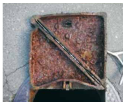
▲腐食したマンホール蓋
