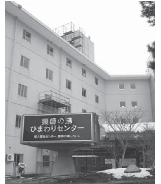
▲急ピッチで改修工事を進める「薬師の湯ひまわりセンター」（3月13日撮影）
