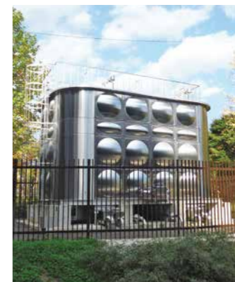
▲上水に統合した湯元第2配水池
