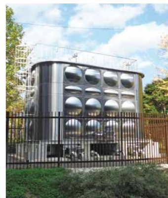
▲上水に統合した湯元第2配水池
